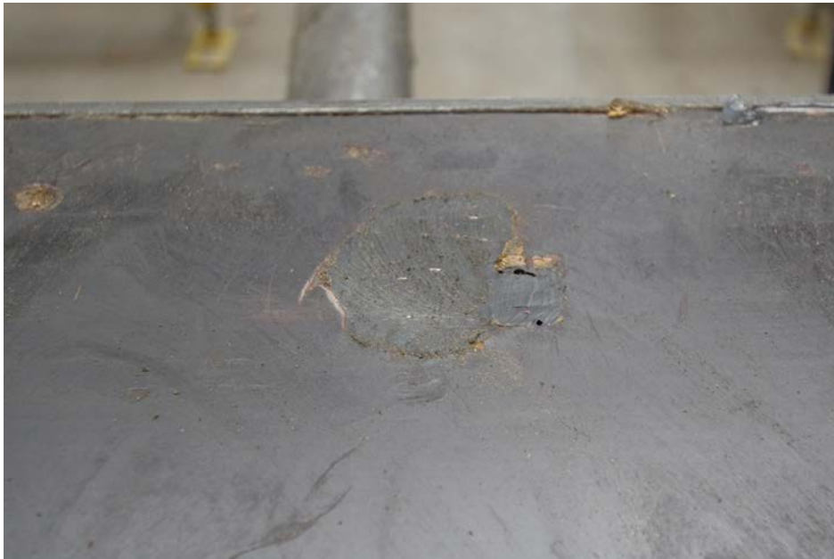
znalezione uszkodzenie – obok starego wypełnienia, które jak widać jest w porządku frezowanie miejsca do zalania klejem – ręczną frezarką elektryczną:
